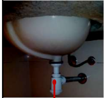
Sifão plástico em lavatório
