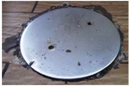
Sifão de pavimento embutido no pavimento com a tampa à vista
