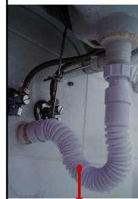
Sifão plástico em lavatório
